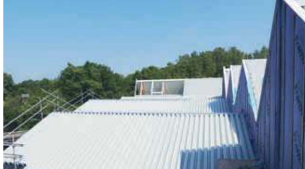
Ter plaatse van de sporthal en de tribune reiken de zadelkappen iets hoger dan boven de andere ruimtes.
