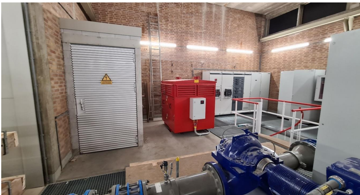
Figuur 7 De nieuwe trafo en schakel- en besturingskasten
